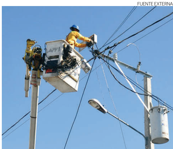
Brigadista revisa cableado.
